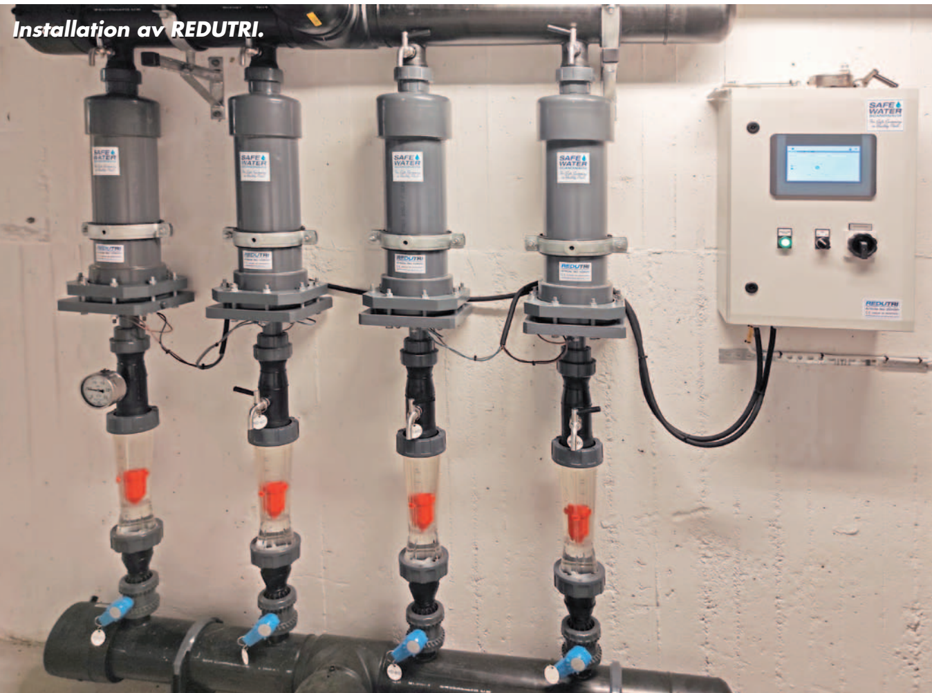
Fyra elektrolysmoduler och styrenhet inkopplade på cirkulationskretsen.
